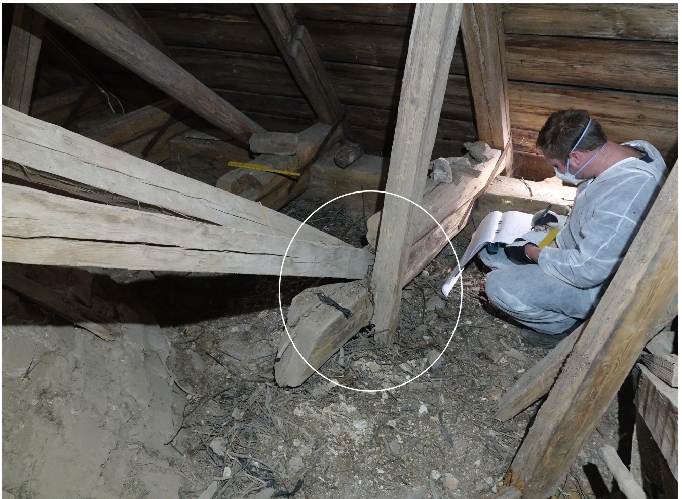
I ett par av norra sidans tassar har dessa rest sig så mycket att knuten med stickstöttan helt gått isär.
