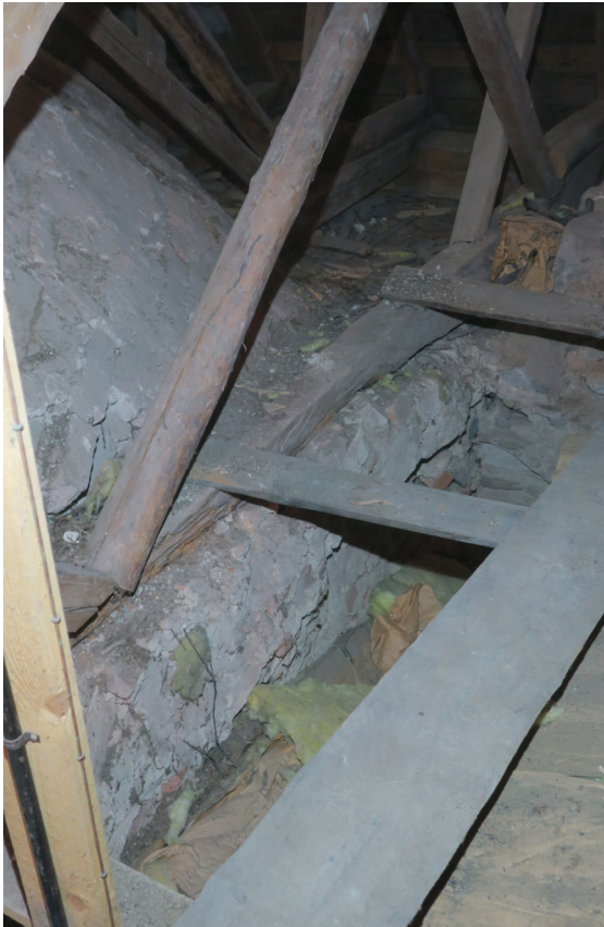
Röta i bindbjälke i nr 13.
