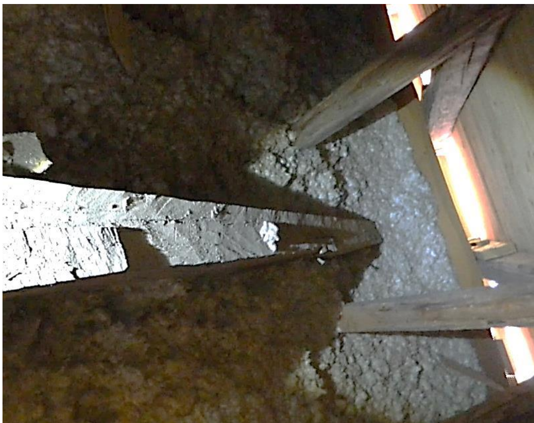
Turinge kyrkas vind är fylld med lösull. Remstyckena ligger döda under massorna. Bildnummer LP_2015_00066. Foto Bengt Bygdén
