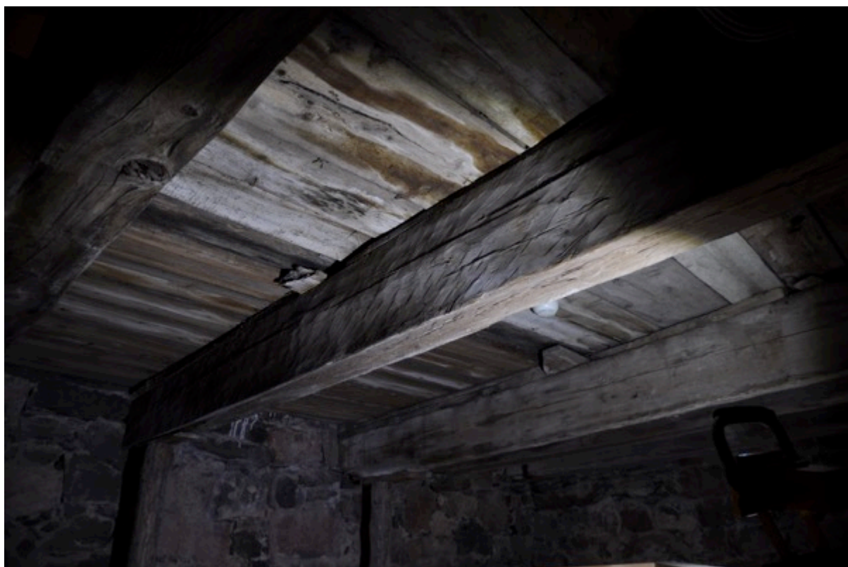
Bilden visar ett av de övre bjälklagen i tornet. Bjälklaget här, består av återanvänt väggtimmer från den medeltida timmerkyrkan. På bjälken mitt i bild, kan man på den hitre breddsidan se de karakteristiska verktygsspår som den medeltida behuggningstekniken ger.
