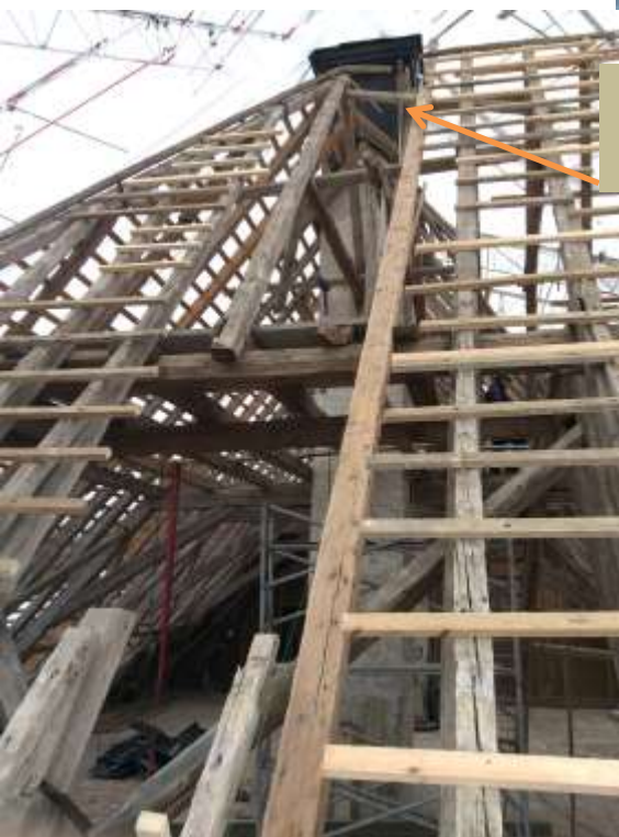
2014 strävan som "räddat" taket.
