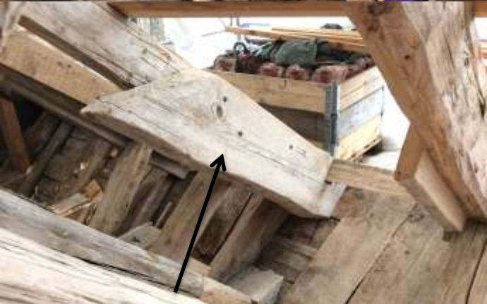
En äldre lagning av en rötskadad nedre påsalningsända.
