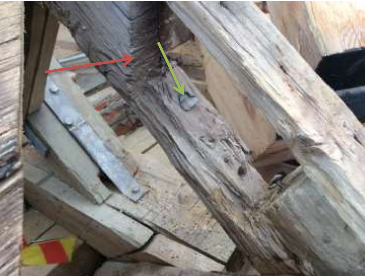
Rester av koppartäckning som blivit kvar när man rev loss plåten. Notera den galet djupa nerhuggningsen i påsalningen som skall bära upp takfoten!
